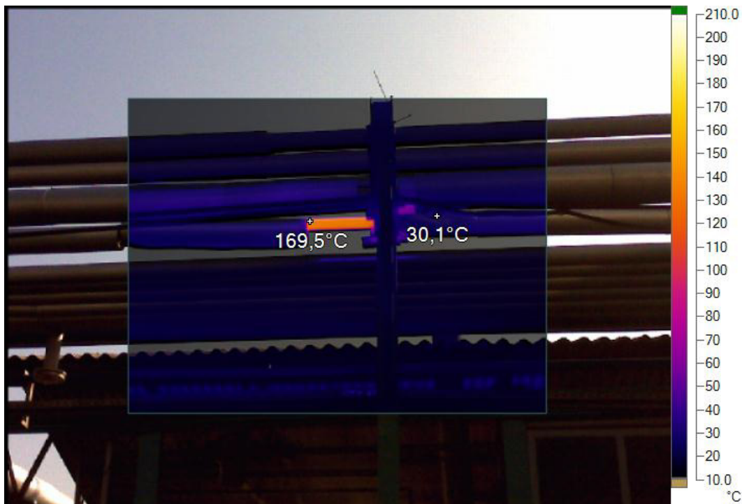
Slika 6. Prikaz merenja temperature izvršenih termovizijskom kamerom cevovoda sa i bez izolacije (spoljašnji prečnik cevovoda 60,3 mm)
